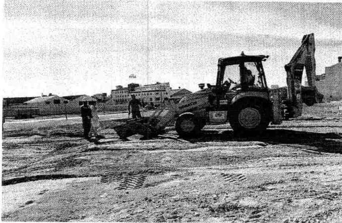
Primeros trabajos para adecuar el solar donde se ubicará el Centro de Día. / NURIA ALFARO
